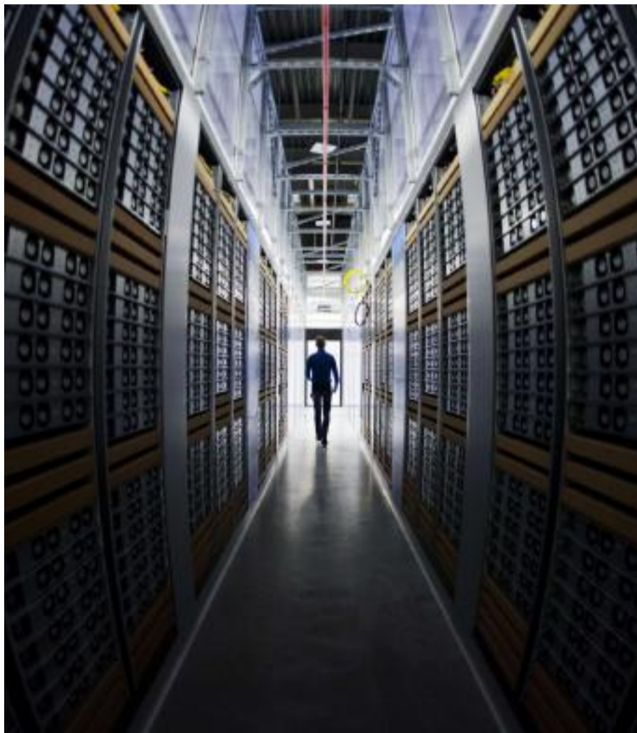
↑ Facebooks datacenter i svenske Luleå har vært i drift siden juni 2013. I Norge er Microsoft den første av de globale gigantene som bygger store datasenter. Selskapet to sentre skal etter planen være i drift i slutten av året. Foto: Jonathan Nackstrand/AFP/NTB Scanpix
